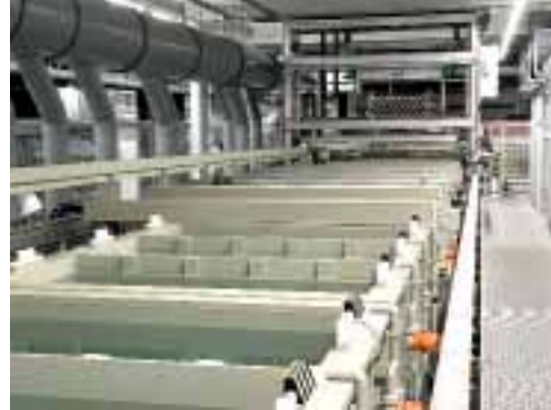
Abb. 3: Verbesserte Anlagenperformance durch deutlich verlängerte Wartungszyklen mithilfe des speziell entwickelten Badpflegesystems
